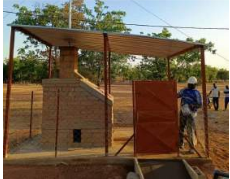
01 incinérateur construit au sein CSPS de la commune de Lèba (Région du Nord)
