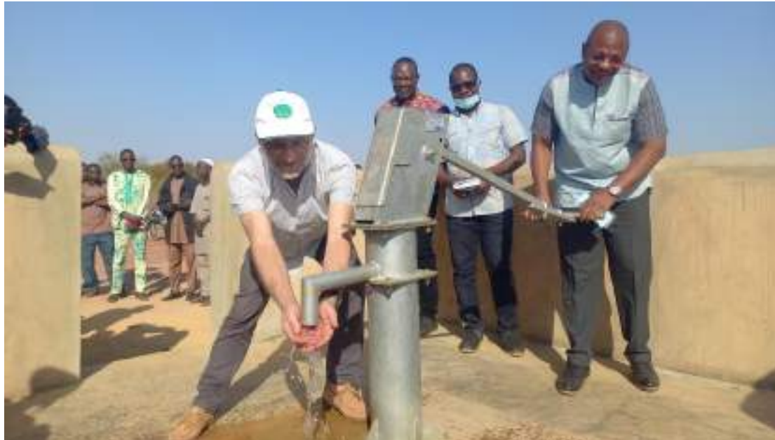
La délégation visite les installations du forage pastoral du Campement peulh de la commune de Poa
