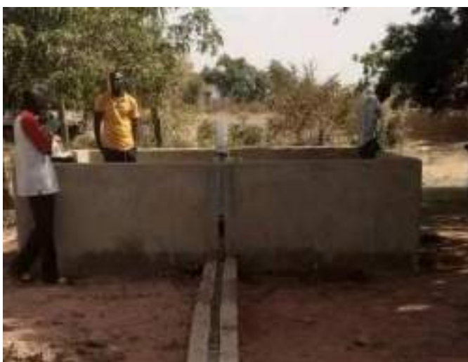
Un forage positif réalisé à l'école primaire publique de Tanghin (Arbollé, Région du Nord)
